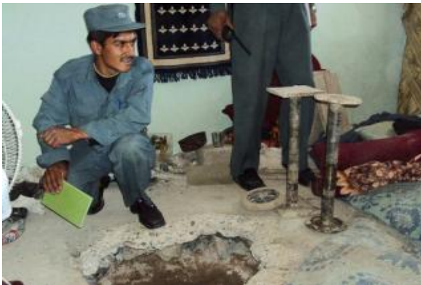
（圖 13. 牢房內水泥地板，被挖地洞脫逃）
